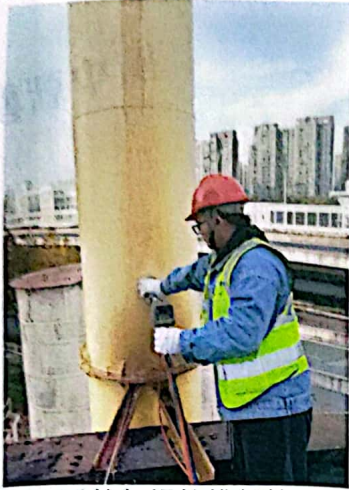
天然气锅炉排气筒
